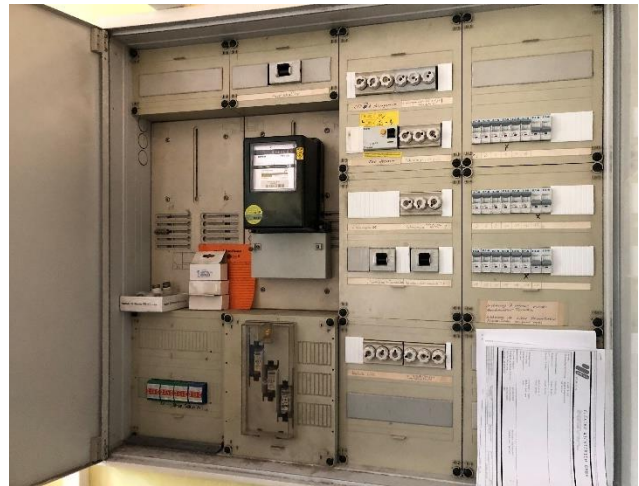
Abbildung 8: Unterverteilung I mit Ferrariszähler (Hausmeisterbüro)
