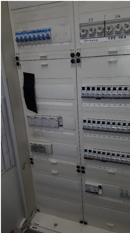
Abbildung 9: Unterverteilung II (Turnhalle)
